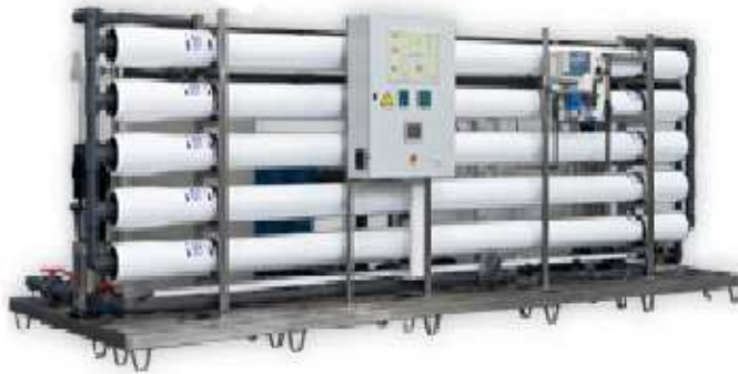
Figura 4: Planta de ósmosis inversa.
