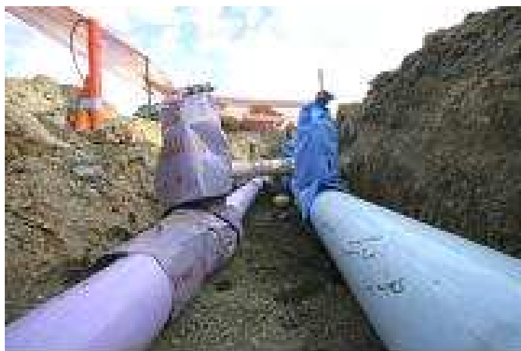
Doble red para distribución de agua potable y agua reclamada
